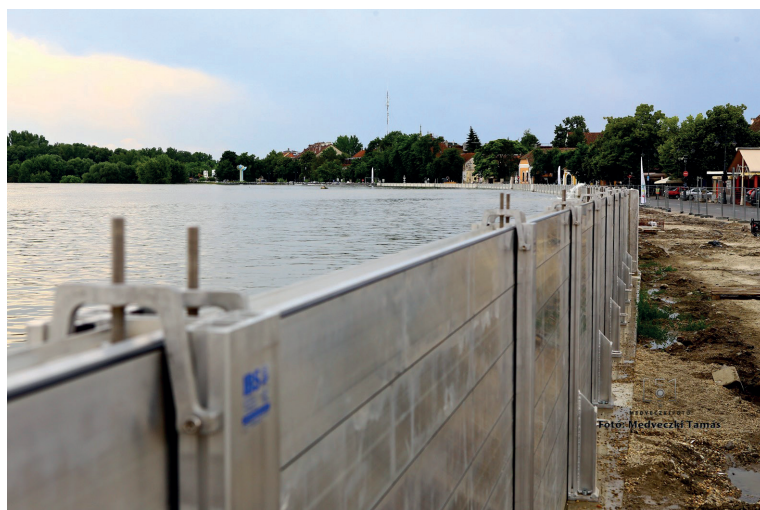
4. ábra. Szentendrén telepített mobil árvízvédelmi fal [19]
