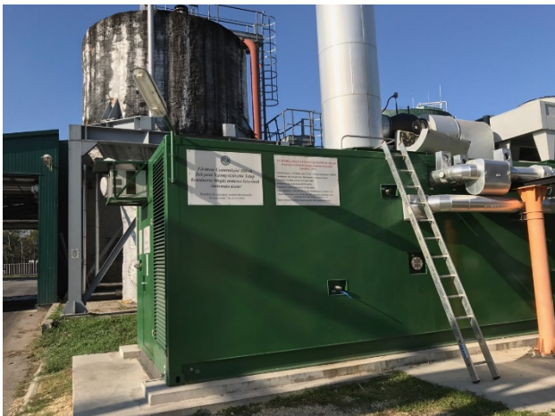
5. ábra Az 1,2 MW-os Caterpillar konténeres gázmotor [10]
