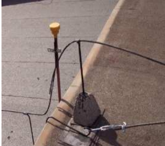
2. sz. kép: Villámhárító a tetőn [11]
