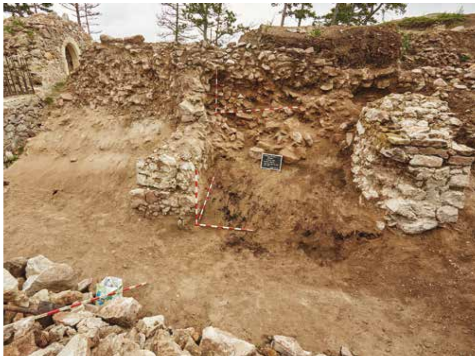
4. kép – A nyugati várfal északi szakasza a támpillérekkel, feltárás közben. Szoboszlai Marcell felvétele, 2020. szeptember 2.
