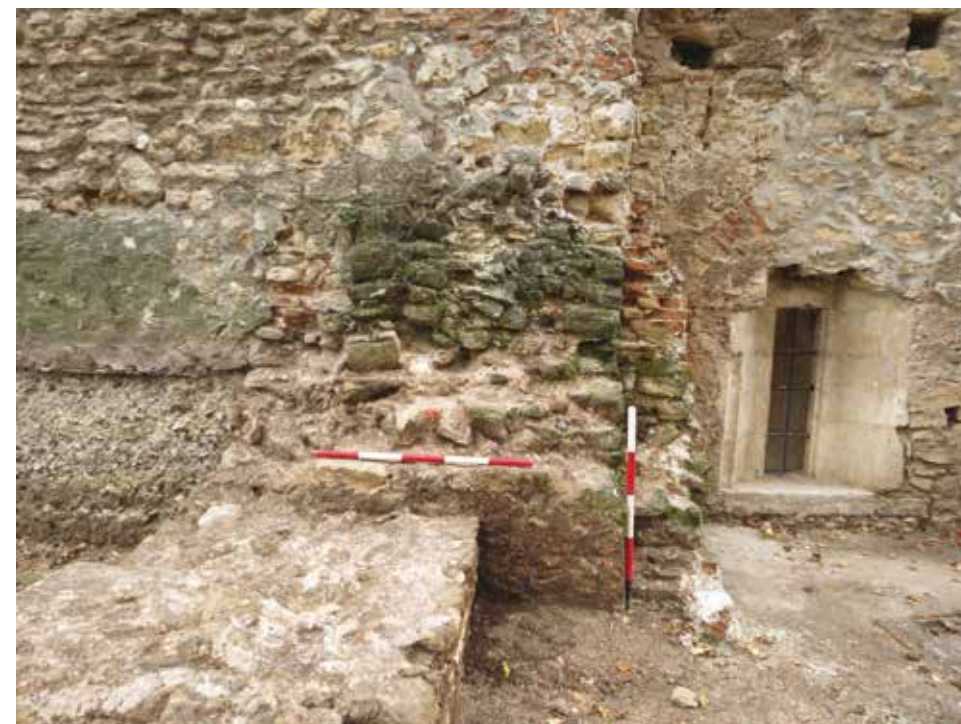
10. kép – A sokszögzáródású védőmű fala a támpillér vakolt falsíkjához utólag hozzáépítve (Fülöp Máté felvétele)
