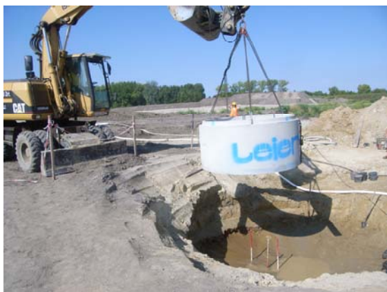
2. ábra: Betongyűrű beemelése a kút gödrébe az emberek védelme és a víz kizárása miatt (fotó: Hatos János)
