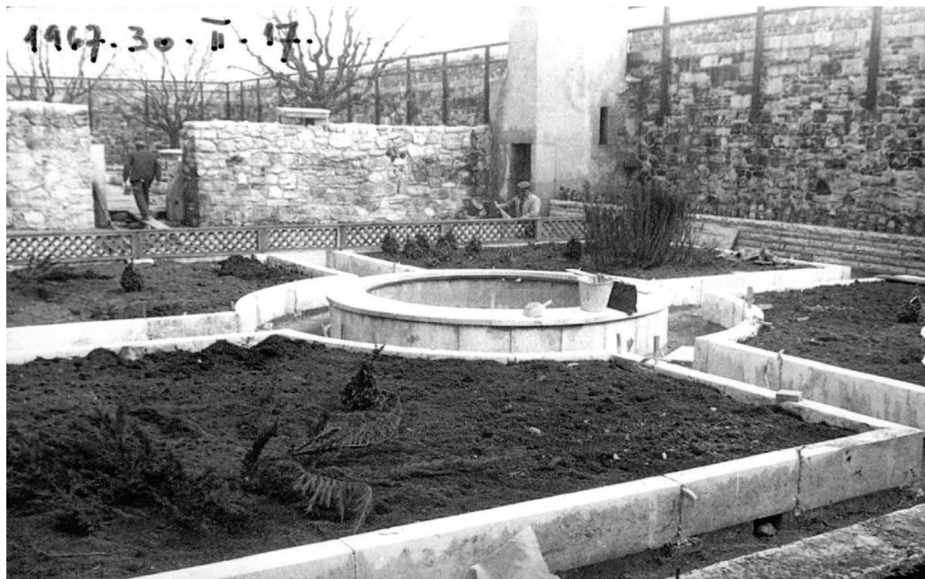
53. A déli zárt kertek építése 1967 februárjában. Az ágyások és a szökőkút mészkő-elemei még fugázásra várnak, és a növényültetés folyik, a kavicsburkolat még hiányzik. A táblákban már beültetett nehézszagú boróka és egy-egy (később átültetett) kúp alakú puszpáng. Az egyik munkás éppen a tervet tanulmányozza. (FŐKERT, zoldkalauz.hu)
