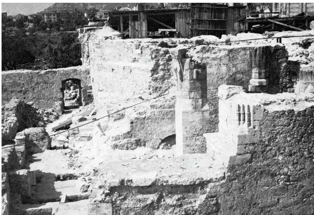
10. A déli udvar feltárása a gótikus nagyterem maradványaival és a télikert még álló alapfalával, 1950. Középen a nyugati várfal déli szakasza a teljes mélységében kibontott középkori szegmensíves kapunyílással (megfigyelhető a kapupántok ma már nem látható helye). Balra egy másik, csak részben kibontott (később visszafalazott) nyílás látható. Az udvar mai szintje mintegy másfél méterrel a feltárt középkori szint fölött van. A felvételt közölte: Gerő 1980, 135
