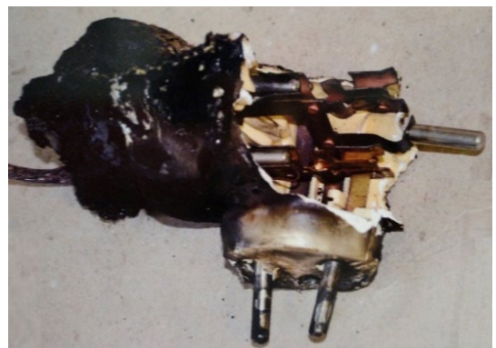
1. ábra. Kontaktkorrozíó okozta károsodás villamos csatlakozónál
