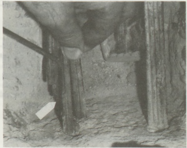
10. ábra A feszítőpázmák szakadt acélszálai
