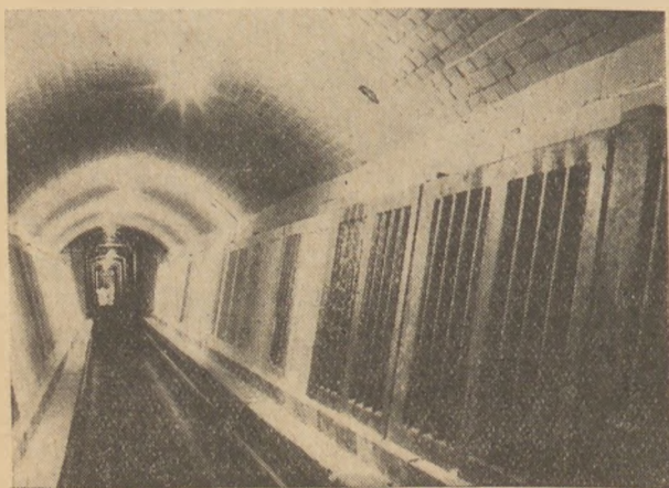
6. ábra. Egészségügyi árut égető kemence belseje az átalakítás után; jól látható a kétféle minőségű szilícium-karbid elhelyezése a különböző zónákban
