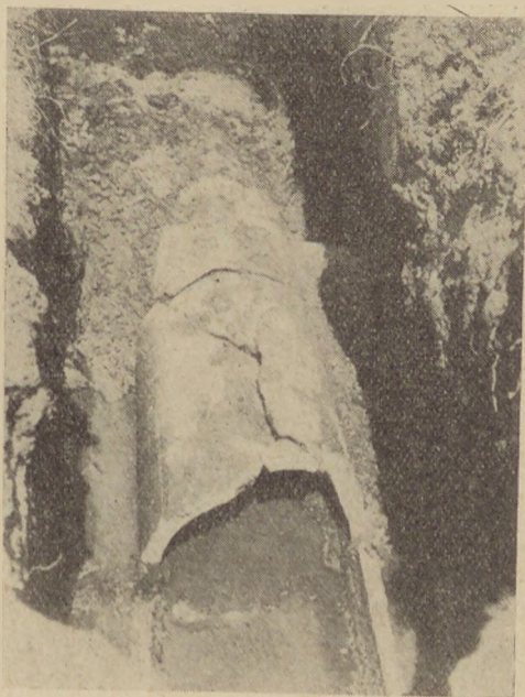
18. ábra. Csatornacsövek korrozioja láptalajban (Wiegner—Gessner kísérletei)
