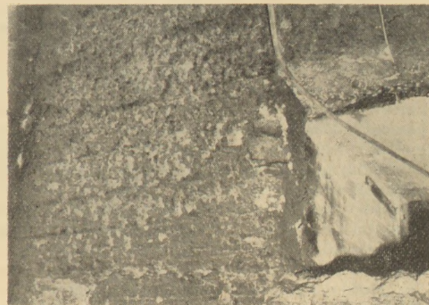
12. ábra. Olajtüzelésű kazán foszfátkötésű korundbeton falazata 6 hónapos üzemeltetés után
