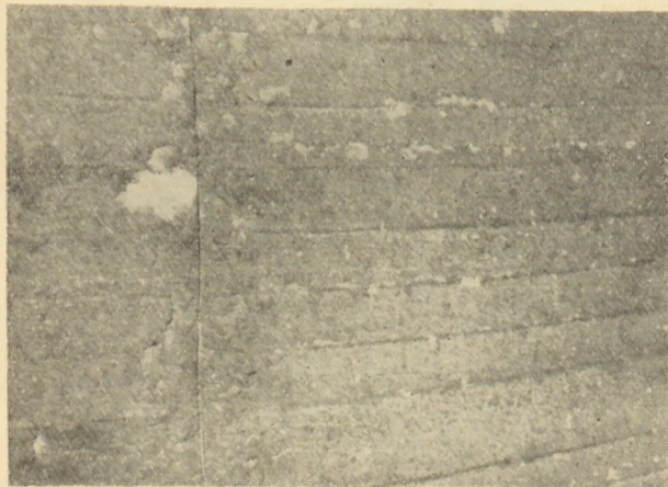
11. ábra. Olajtüzelésű kazán foszfátkötésű korundbeton falazata hat hónapos üzemeltetés után
