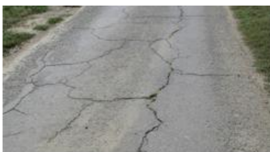
6. ábra. Blokk repedések (párhuzamos és merőleges repedések) (Nagy 2019) Figure 6. Block cracks (parallel and perpendicular cracks) (Nagy 2019)
