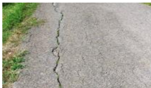
5. ábra. Az út tengelyével párhuzamos repedések (Nagy 2019) Figure 5. Parallel cracks with the road axis (Nagy 2019)
