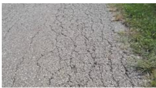
7. ábra. Fáradási (aligátor) repedések (Nagy 2019) Figure 7. Yield (alligator) cracks (Nagy 2019)
