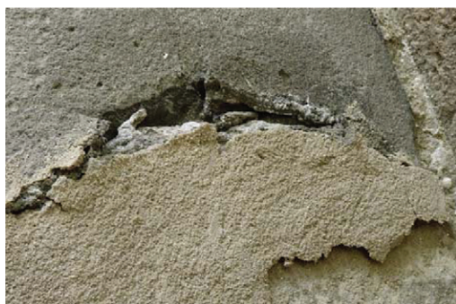
Fig. 1. Loss compensation with incompatible repair mortar. 1. ábra Kőkiegészítés nem kompatibilis habarccsal.
