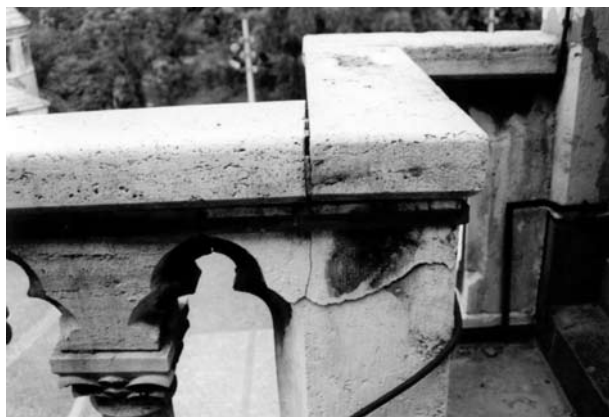
3. ábra. Átrepedt forrásvízi mészkő korlát pántolás rögzítése. Az esőtől védett részekben fekete mállási kéreg van a mészkövön
