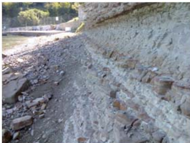
3. kép: Vízszintes helyzetű recens színlők Picture 3: Recent horizontal position notches
