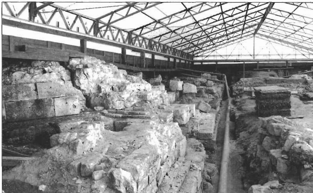
Az 1993–94-ben előkerült falak ideiglenes védelme sátor alatt The temporary prevention of the walls uncovered in 1993–1994, under canvas Fotó – Photo: Gelencsér Ferenc
