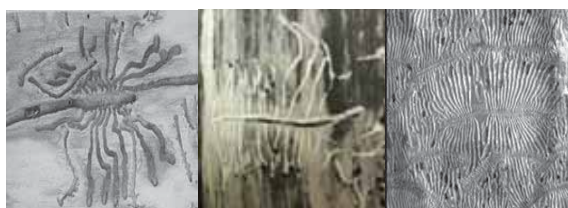
10-12. ábra. Szú rágta fafelület, táplálkozás és egyben bontás - építés.
