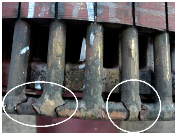
7. ábra Forgórész, a rövidrezáró gyűrűkből kitört pálcavégekkel
