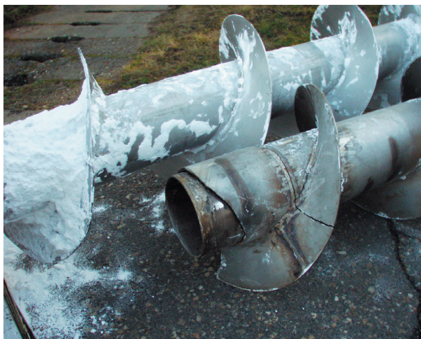
3. ábra. Szállító csiga károsodott tengelye.
