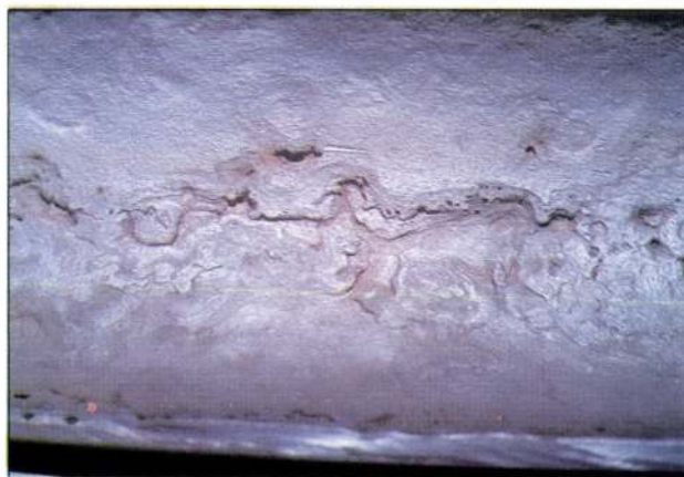
9. kép. Bemaródásos korrózió és lyukkorrózió a PFT-3 és PFT-7 vezetékben
