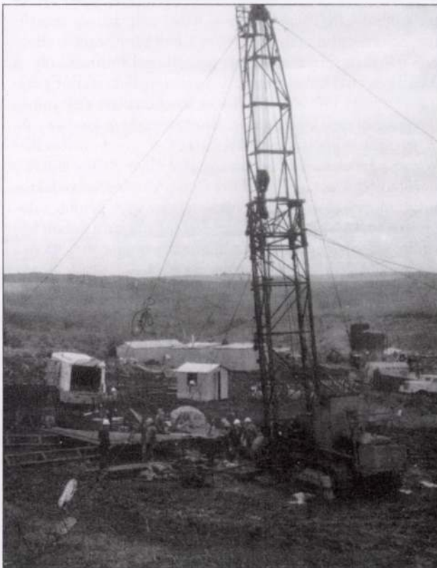
3. ábra. A begyújtófej egy korábbi, még korszerűtlen beépítése Fig 3. Installation of the ignition head, using a former, obsolete technology
