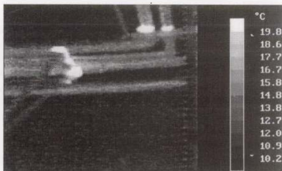
3. ábra. Egy gőzvezeték szigetelési hibái
