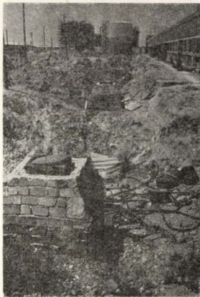
6. ábra Csatornaaknak építése, háttérben a tűzvíztároló tartályok és javítóüzemek építés közben (székesfehérvári ÁFOR-telep)
