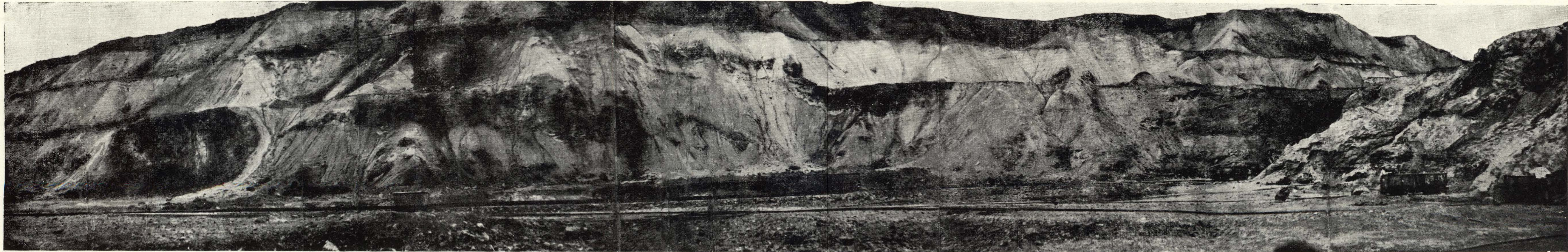
52. ábra. Az Andrassy III. külfejtés vetőkkel, eltolódásokkal és átpikkelyeződéssel tagolt, kampili márgába gyúrt barnavasércetestet Fig. 52. Les corps de minéral limonitique de l'exploitation à ciel ouvert Andrassy III., divisés par failles dislocations horizontales et de l'écaillage répété, pétris dans la n. arne campilienne
