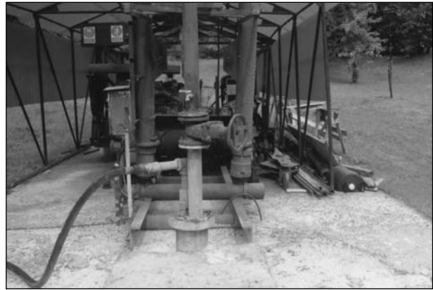
1. kép. Az üzemelő bükkszéki karsztos hévízkút
