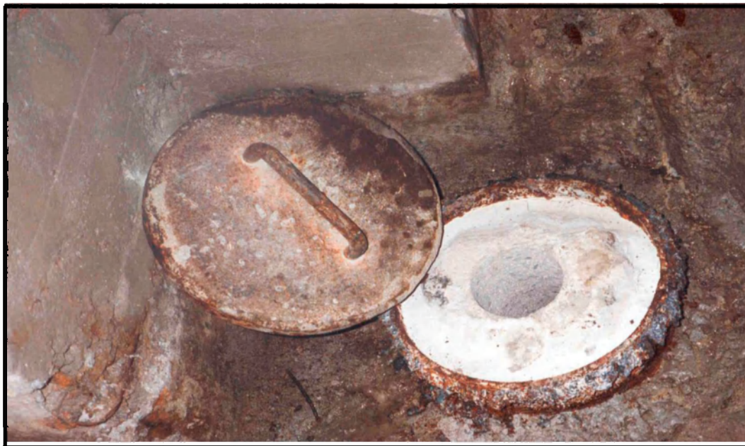
10. sz. ábra A robbantókamra felnyitása után a fémcső és az azt lezáró aknatető elhelyezkedése a betonban
