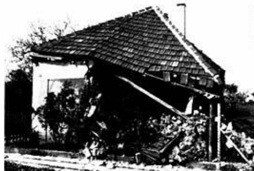
3. ábra A legsúlyosabb épületkár
