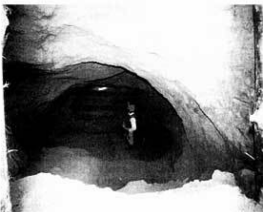
5. fotó Erzsébet községben (Baranya m.) közművíz bejutás nyomán 6 m átmérőjű kupolával szakadt fel egy mélypince
