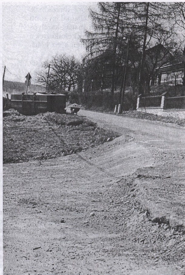
3. fotó. A Dózsa Gy. u-on keletkezett repedés, süllyedés (húzott zóna)
