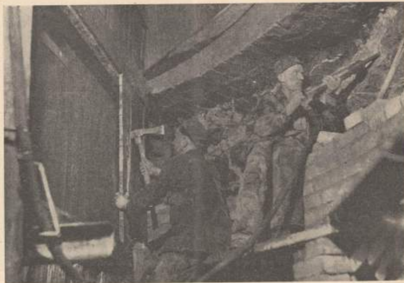
3. kép. Vaslemez burkolás bemutatása a szállítóosztályon belül és az utánvét szakaszban függőleges védőpallók leszerelése, fejtőkulapéccsal való utánrészelés.
