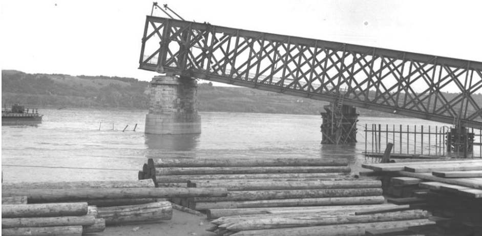
13. ábra. Újvidék, a lerombolt vasúti híd maradványa. Előtérben a helyreállításhoz felhalmozott javítóanyag (Fortepan 107673)
