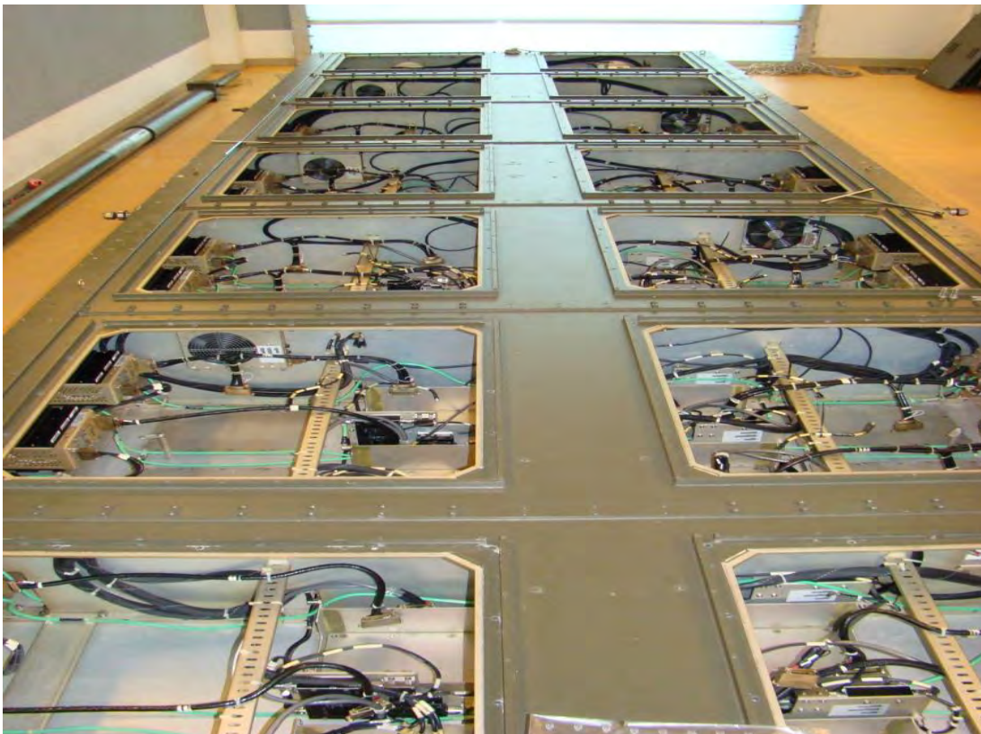
14. ábra Array Cabinet átalakítása
