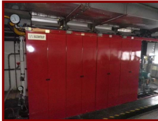
2. ábra. A toronyház jelenlegi kazántelege
