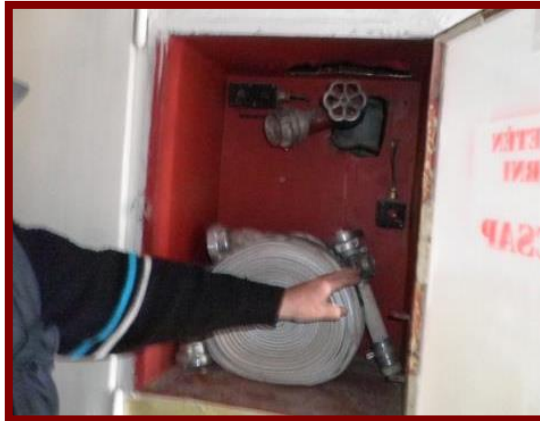
9. ábra. Szintenként kialakított fali tűzcsap a hozzá tartozó szerelvényekkel
