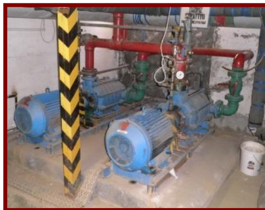
6. ábra. A két tűzvíz szivattyú
