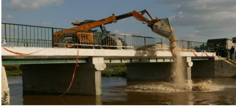
2. ábra. Kárelhárítási munkák a vörösiszap-katasztrófa után (Torna-patak, Marcal). 2010. október 2
