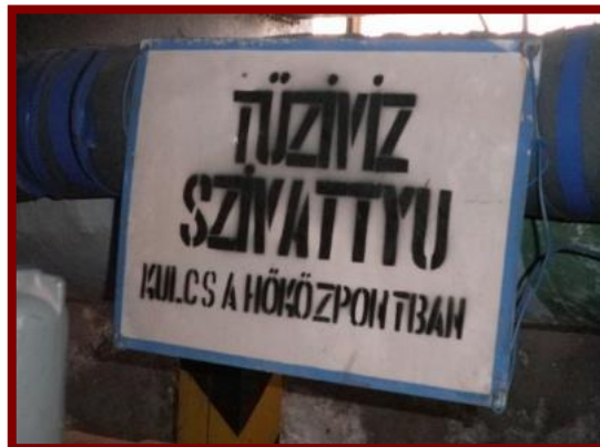
5. ábra. A tűzvíz szivattyú jelölve is van
