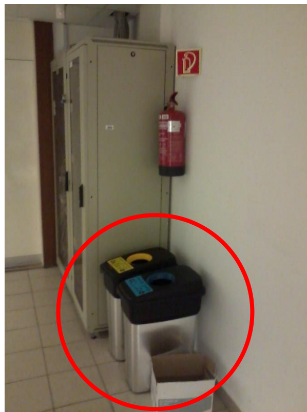
4. kép Csak nyújtott karokkal elérhető tűzoltó készülék (saját felvétel)
