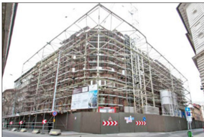
2. ábra: Az acél szerkezettel megtámasztott homlokzati falazat
