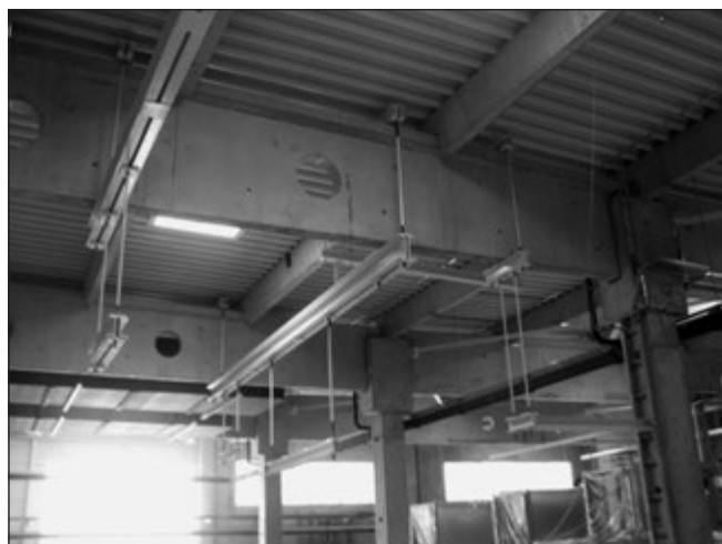
14. ábra: Feszített tetőgerenda a gépészeti csövek felfüggesztő szerelvényeivel
