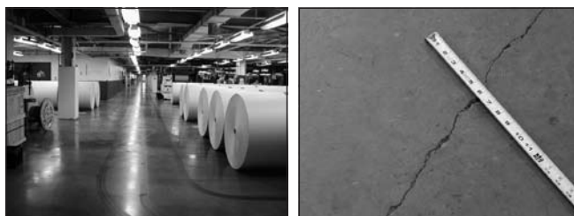
18.a,b ábrák: NY Post Nyomda Épület beton földem, New York, NY Repedés jele
