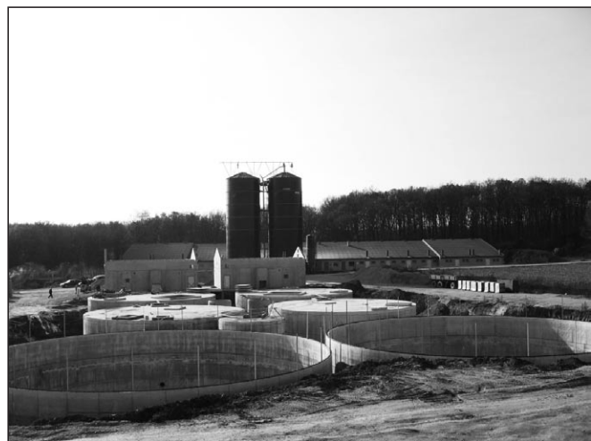
8. ábra: Biogázberendezés a burgenlandi Pöttelsdorfbán
