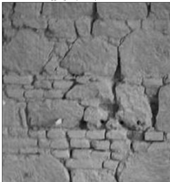
3. ábra: Előtéri fal függőleges repedése
