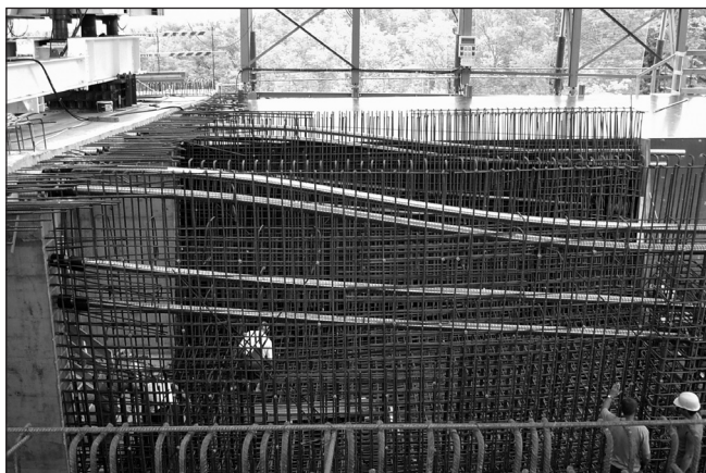
5. ábra: Kábelek a középső bordában
