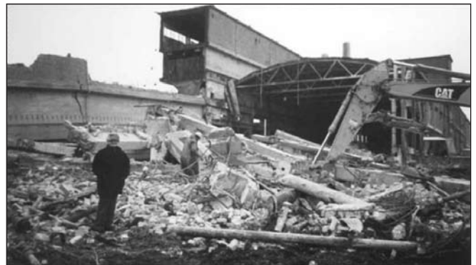
2. ábra: A felrobbantott csarnok
