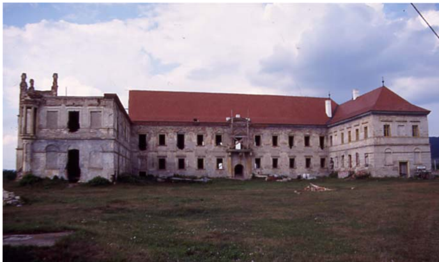
Abbildung 25: Bánffy-Schloß von Bruck. Innere Hoffassade während der Restaurierung. 2001. Foto: Nils H. Măzgăreanu (UIM SoSa: Fotoarchiv)
