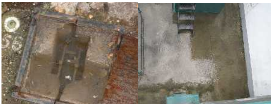
8. ábra. Kamra illetve parapetfal melletti szivárgó vizek LNV alatt
