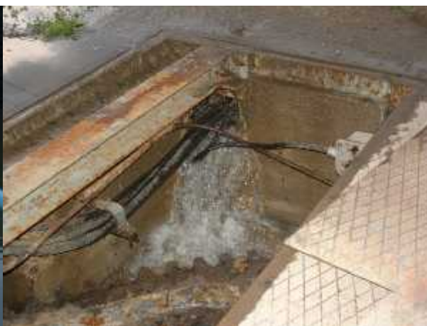
6. ábra. Er teljes vízbetörés a kábel alagútban
