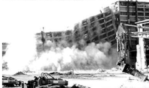
4. kép: A Ganz Villamossági Művek „F” épületének robbantása
