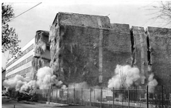
2. kép: Épületrobbantás a Siemens gyár irodája mellett
