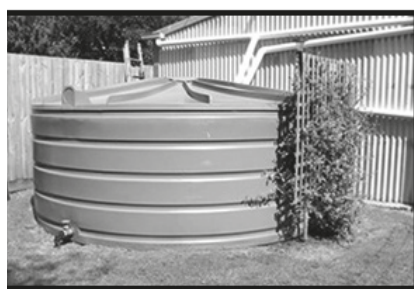
9. kép. A csapadékhasznosító rendszer
