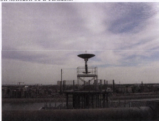
Műholdvevő-állomás a légymányosi épület tetején.
