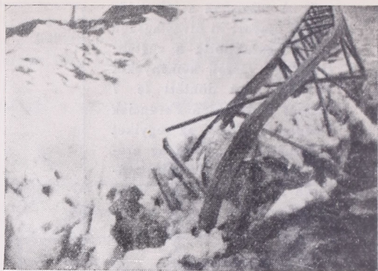
5. ábra. A vihar által a betonnal együtt kiszakított vasoszlop a Pécs—Szentlőrinc országúton. (Pósta felvétele.)
