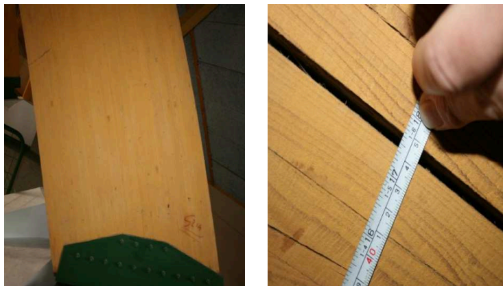
1. ábra A harkányi tornacsarnok vékony lamellás ép és vastag lamellás repedt tartói
