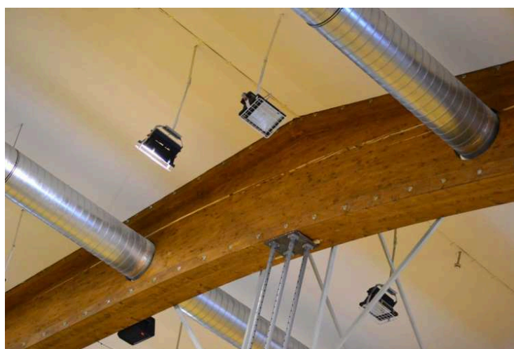
3. ábra Tapolca, városi rendezvénycsarnok: fogyószálás rész lerepedése Figure 3 Crack of the outrunning grain in the Tapolca town-hall
