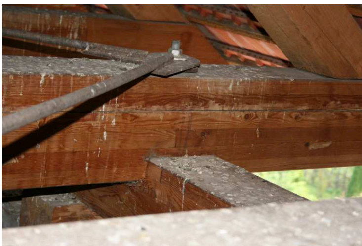
2. ábra A kisharsányi templom tetőszerkezetének repedése az erőbevezetésnél Figure 2 Crack at the loading point in the roof-construction of the church in Kisharsány
