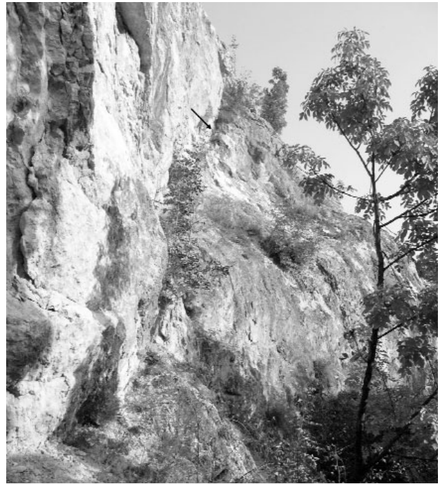
11. kép. A feltolódásként értelmezett repedés (nyíl) (2011)
