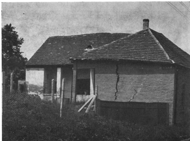
2. ábra. Mozgásokból eredő épületkár Rácalmás
