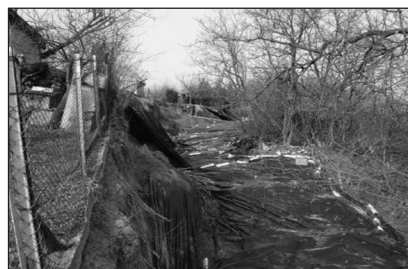
7. kép. Ivó utcával párhuzamos szakadás 1/4 (2011-01-21) (Forrás: Sycons Kft.)
