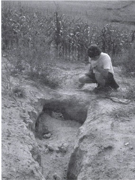
6. kép. A felszíni eróziót a felszín alatti alagosodás segíti Piping phenomena support surface erosion in the gullies
